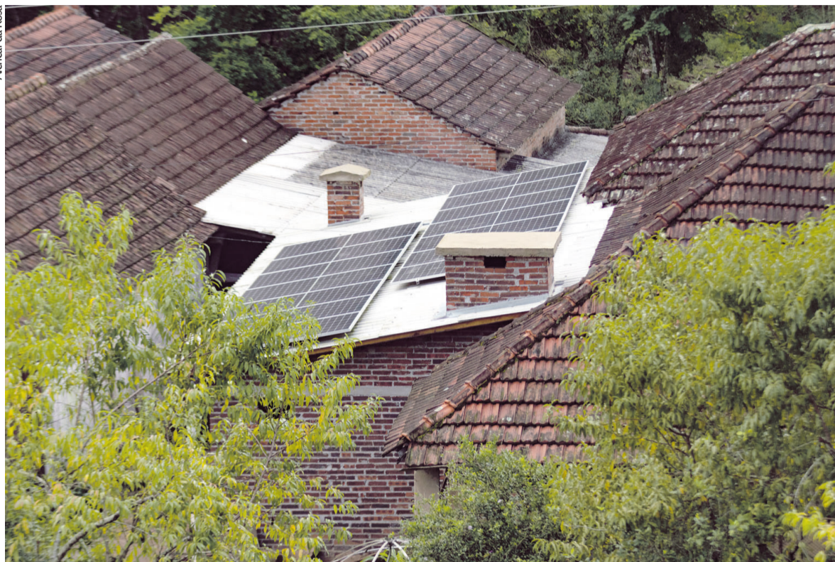
Santa Cruz: placas de captação da energia solar foram instaladas no telhado da residência de Leandro e Camila, em Rio Pardo
