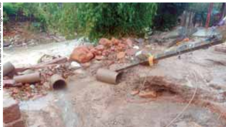
Força das enxurradas arrancou tubulações e cercas em diversos pontos do município
