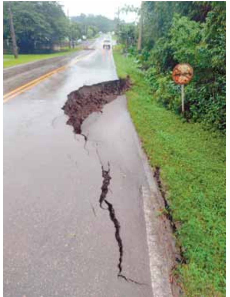
Com rachadura e possibilidade de desmoronamento, acesso via ERS-418 foi fechado
