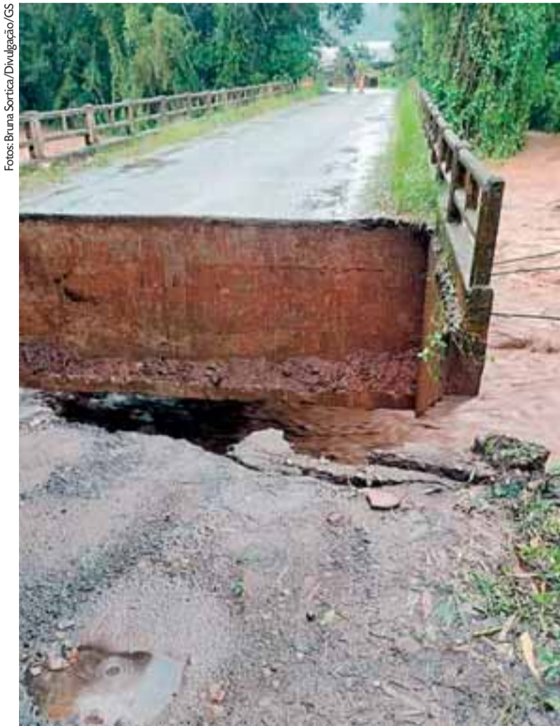
Cabeceiras das pontes que ligam Linha Antão e o Centro de Linha Brasil não resistiram
