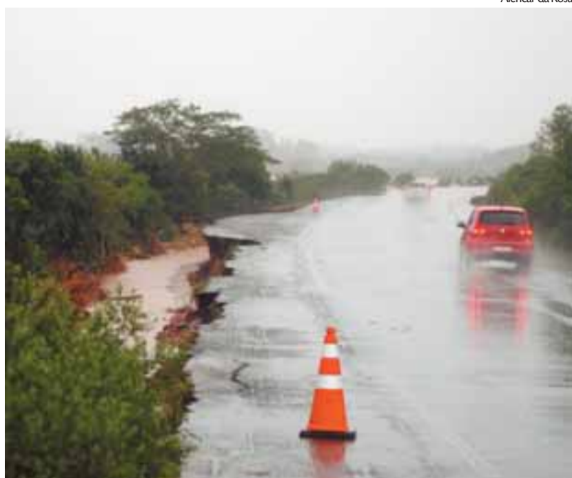
No fim da tarde, pelo menos 41 vias da malha estadual tinham danos e alterações no tráfego
