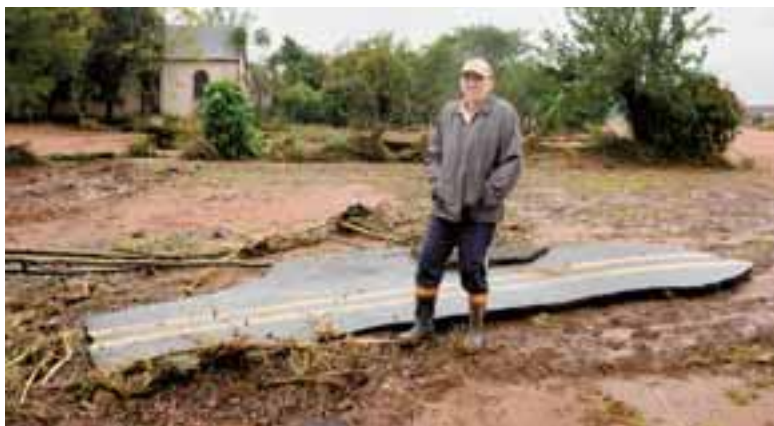
Agricultor René Türk se assustou ao ver parte do asfalto da VRS-858 sobre o pátio
