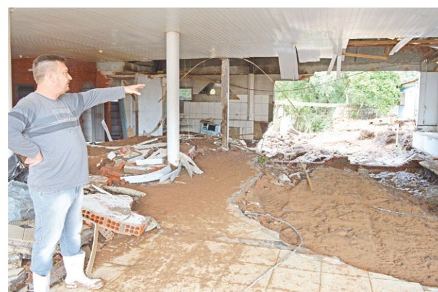
O que sobrou do Restaurante Caldeirão - Ibarama
