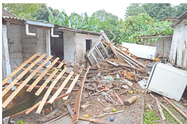
Residência destruída no Bairro Baixada
