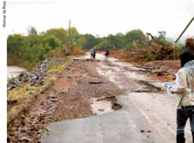
Uma das vias mais danificadas no município é a que passa pela região de Linha do Rio
