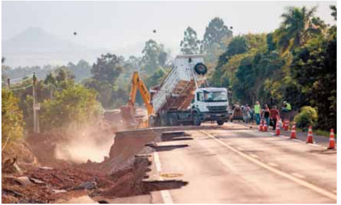
Em Candelária, equipes da concessionária iniciaram um reparo emergencial da pista para permitir a retomada do fluxo de veículos
