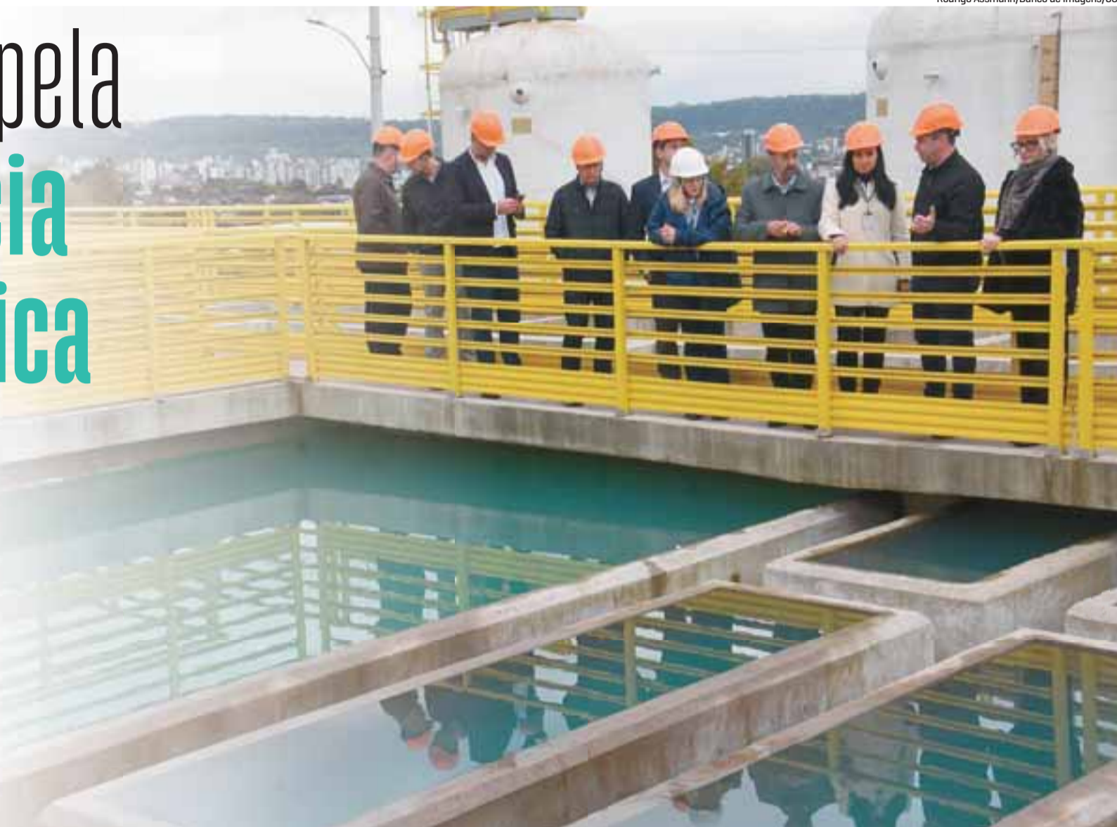
Um dos exemplos de aplicabilidade da eficiência energética da Corsan é a instalação da nova Estação de Tratamento de Água, considerada a mais moderna do País
